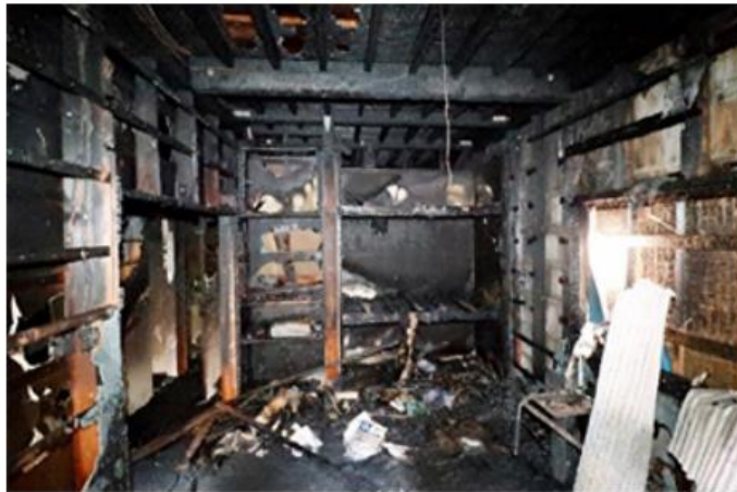
出火箇所の状況
