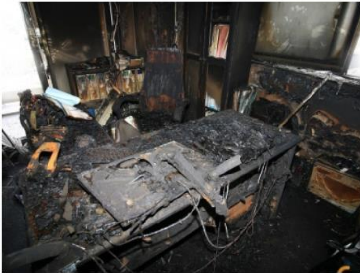
事務室の焼損状況
