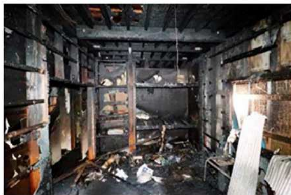
出火箇所の状況
