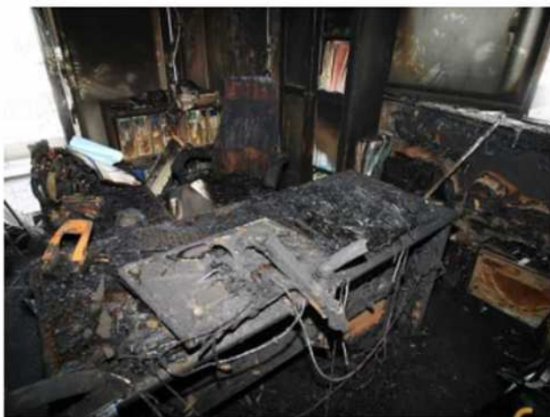
事務室の焼損状況
