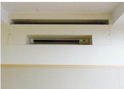
● 壁に埋め込んだエアコン
