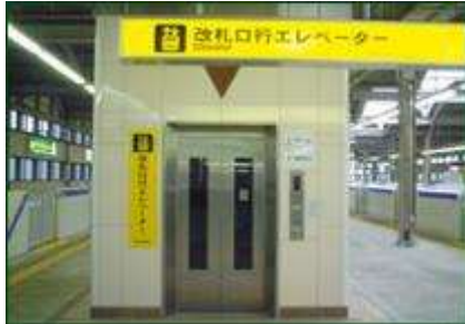
エレベーター等による1ルート確保状況 〈都市整備局・交通局〉
